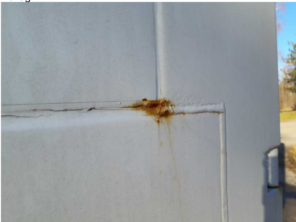
Gebrauchsspur 1: Karosserie: Karosserie - beschädigt - kein Abzug
