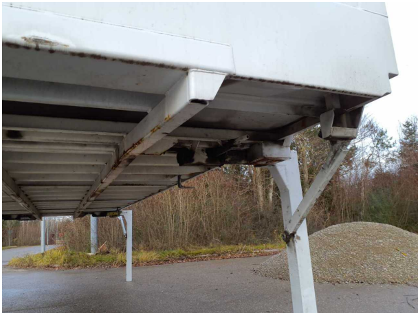
Gebrauchsspur 1: Karosserie: Karosserie - beschädigt - kein Abzug
