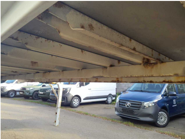
Beschädigung 1: Aufbau: Aufbau - Korrosion - instandsetzen und lackieren
