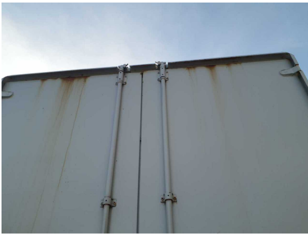
Beschädigung 1: Aufbau: Aufbau - Korrosion - instandsetzen und lackieren
