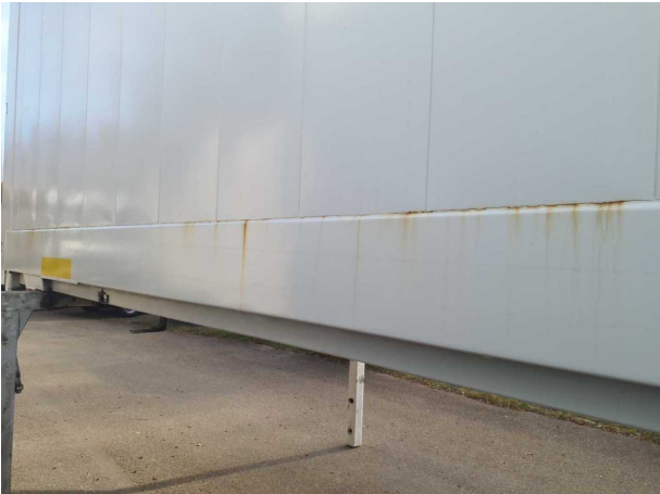
Beschädigung 1: Aufbau: Aufbau - Korrosion - instandsetzen und lackieren
