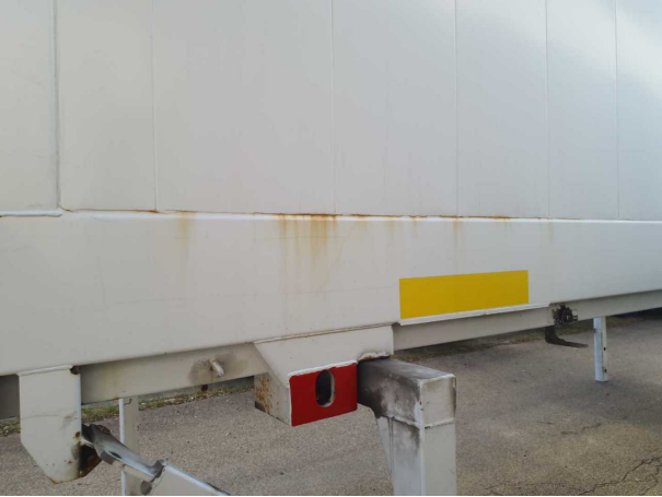
Beschädigung 1: Aufbau: Aufbau - Korrosion - instandsetzen und lackieren
