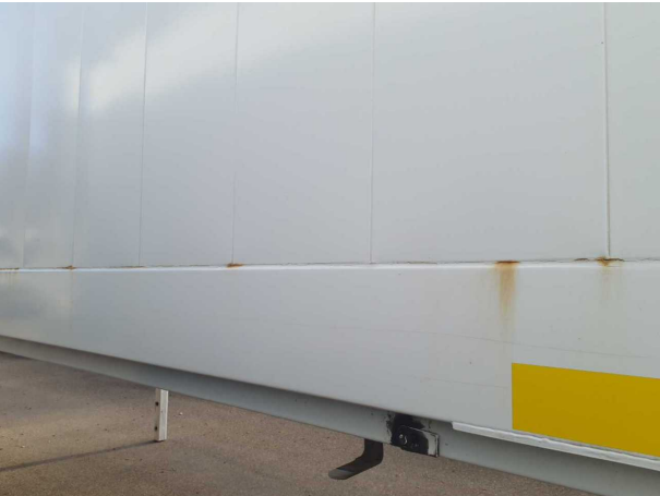
Beschädigung 1: Aufbau: Aufbau - Korrosion - instandsetzen und lackieren
