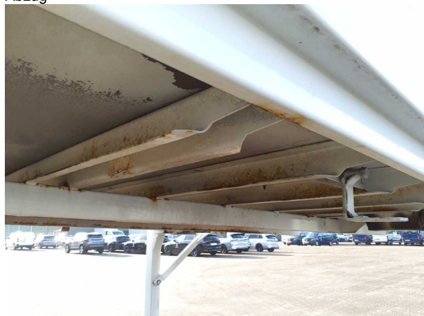
Gebrauchsspur 1: Karosserie: Karosserie - Korrosion - kein Abzug
