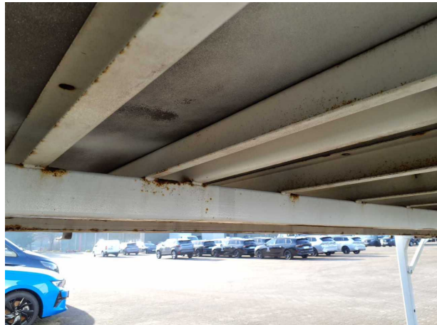
Gebrauchsspur 1: Karosserie: Karosserie - Korrosion - kein Abzug
