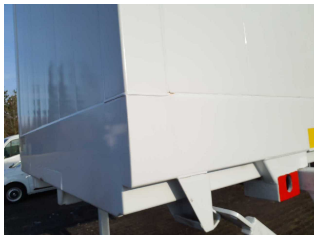
Gebrauchsspur 1: Karosserie: Karosserie - Korrosion - kein Abzug
