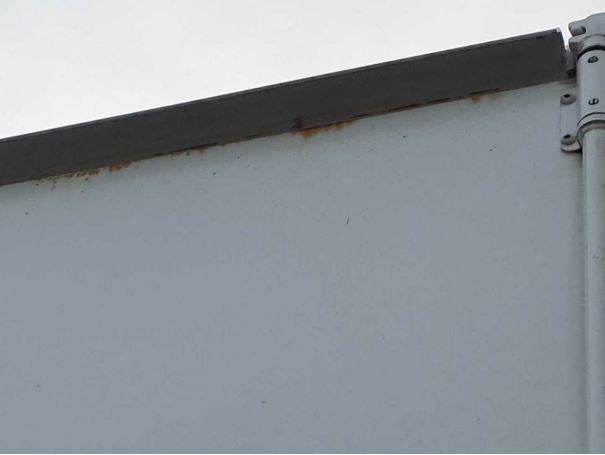
Beschädigung 1: Aufbau: Aufbau - Korrosion - instandsetzen und lackieren
