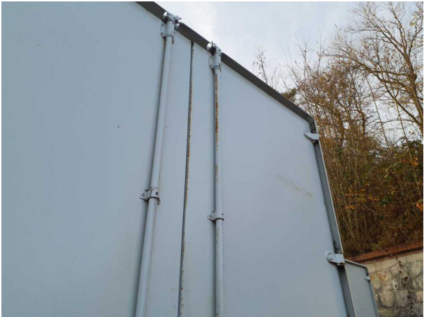
Beschädigung 1: Aufbau: Aufbau - Korrosion - instandsetzen und lackieren
