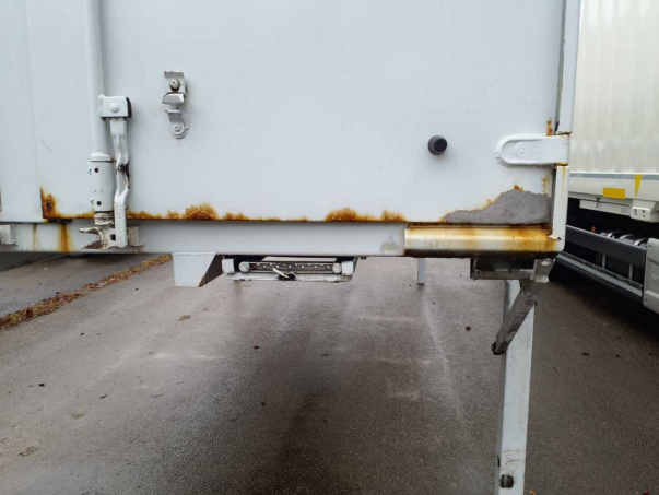
Beschädigung 2: Aufbau: Aufbau - Korrosion - instandsetzen und lackieren
