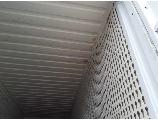
Beschädigung 2: Aufbau: Aufbau - Korrosion - instandsetzen und lackieren
