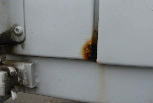
Beschädigung 1: Aufbau: Aufbau - Korrosion - instandsetzen und lackieren
