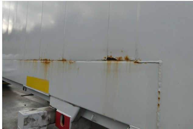
Beschädigung 1: Aufbau: Aufbau - Korrosion - instandsetzen und lackieren
