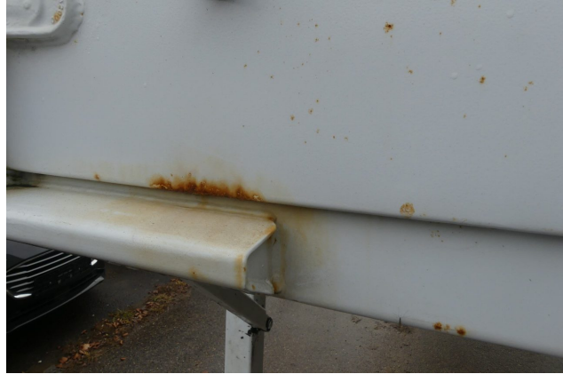
Beschädigung 1: Aufbau: Aufbau - Korrosion - instandsetzen und lackieren
