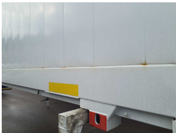
Gebrauchsspur 1: Aufbau: Aufbau - Korrosion - kein Abzug
