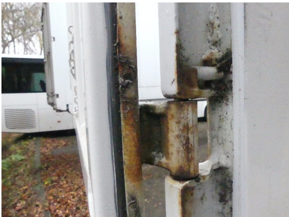
Bild 11: Tür links Korrosion - teillackieren
