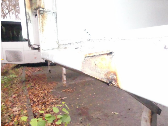
Bild 7: Portalrahmen unten Korrosion - lackieren
