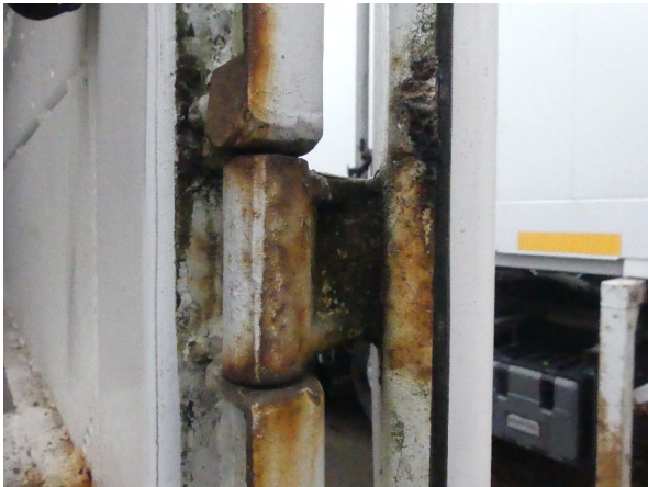
Bild 15: Tür rechts Korrosion - teillackieren
