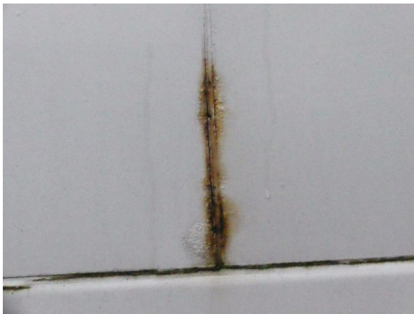
Bild 21: Seitenwand rechts Korrosion - lackieren
