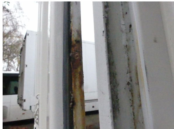
Bild 12: Tür links Korrosion - teillackieren
