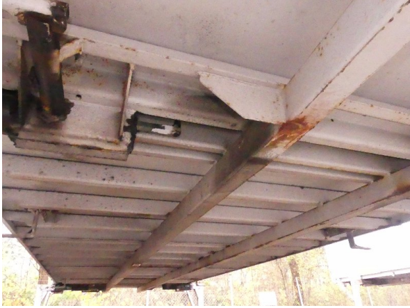
Bild 25: Rahmen und Stützbeine Korrosion - ohne Reparatur
