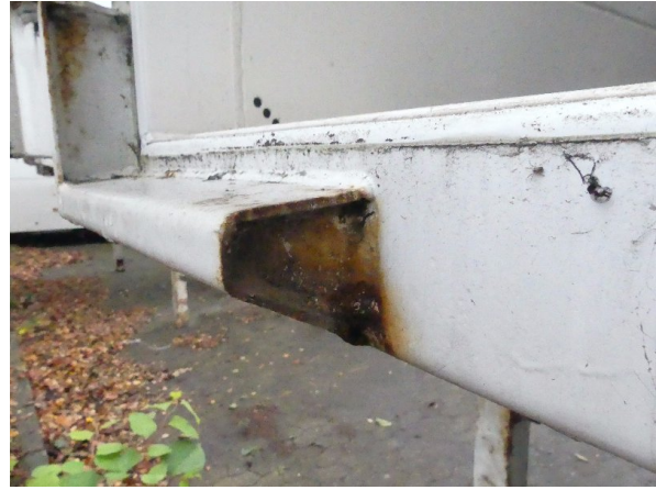
Bild 8: Portalrahmen unten Korrosion - lackieren
