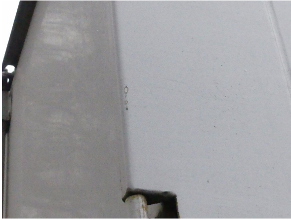
Bild 19: Portalrahmen rechts Korrosion - teillackieren
