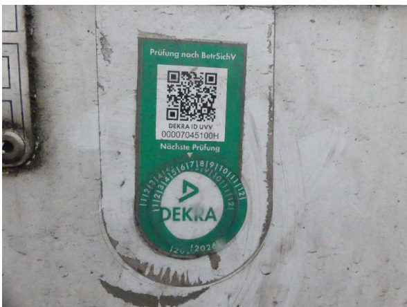
Bild 5: UVV Bescheinigung fehlt - erneuern
