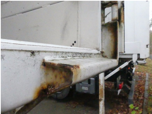
Bild 9: Portalrahmen unten Korrosion - lackieren
