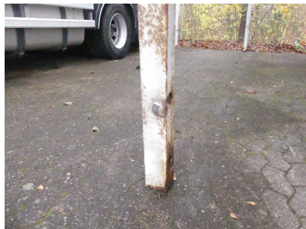
Bild 24: Rahmen und Stützbeine Korrosion - ohne Reparatur
