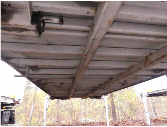
Bild 7: Rahmen und Stützbeine Korrosion - ohne Reparatur
