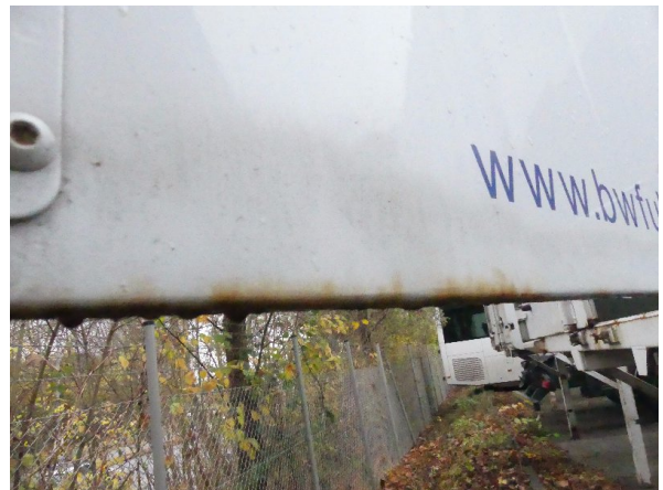
Bild 24: Tür rechts Korrosion - teillackieren
