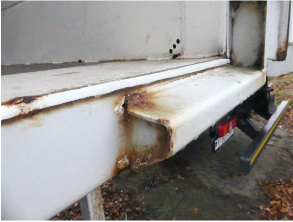
Bild 13: Portalrahmen unten Korrosion - lackieren
