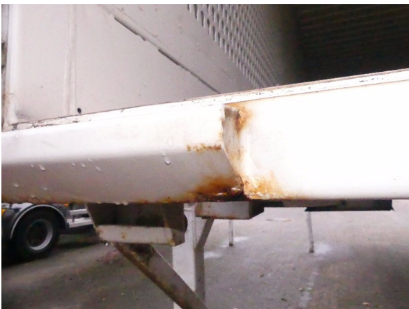
Bild 11: Portalrahmen unten Korrosion - lackieren
