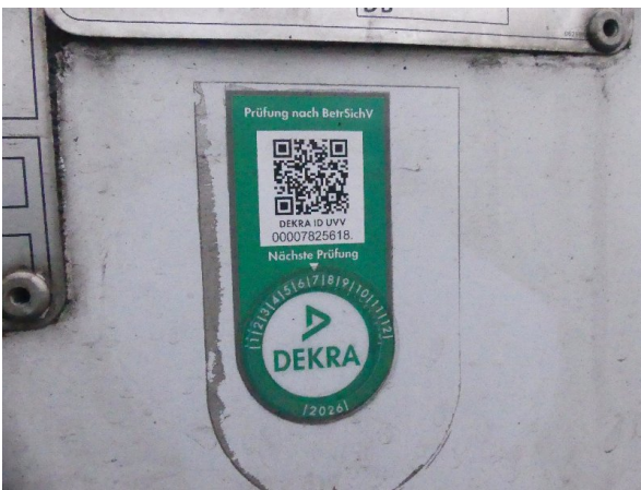
Bild 9: UVV Bescheinigung fehlt - erneuern
