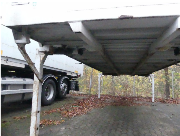
Bild 5: Rahmen und Stützbeine Korrosion - ohne Reparatur
