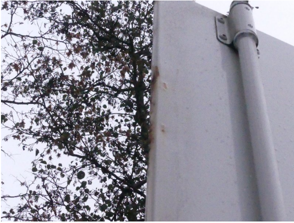
Bild 25: Tür rechts Korrosion - teillackieren
