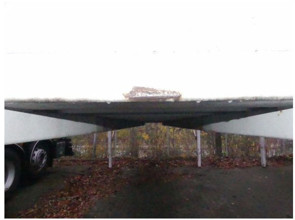
Bild 8: Rahmen und Stützbeine Korrosion - ohne Reparatur
