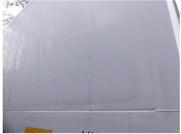
Bild 26: Seitenwand rechts Lackabplatzung - teillackieren
