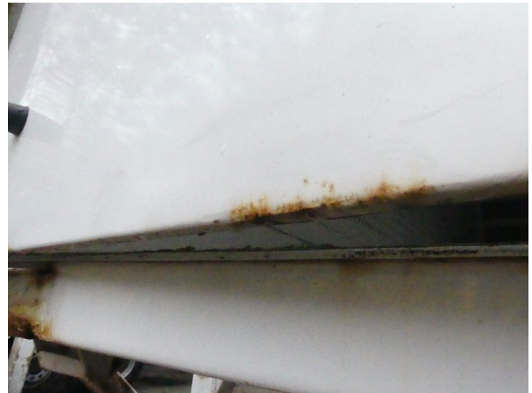
Bild 16: Tür links Korrosion - teillackieren
