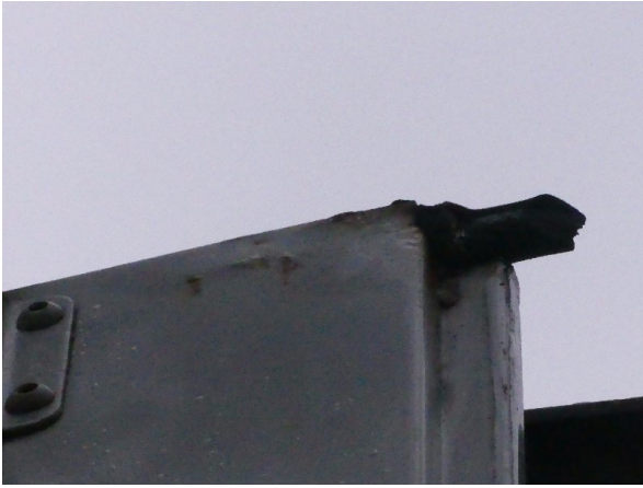
Bild 19: Tür links Korrosion - teillackieren
