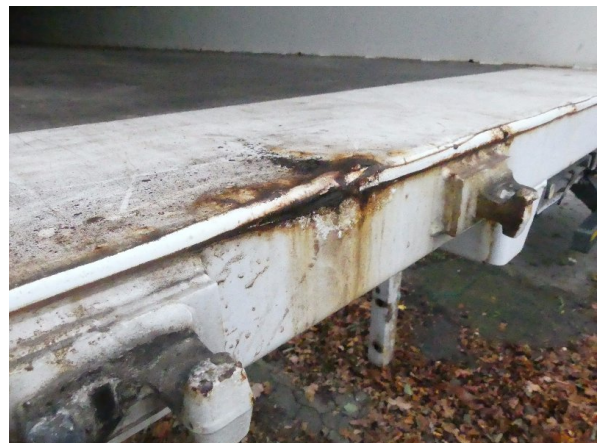
Bild 12: Portalrahmen unten Korrosion - lackieren
