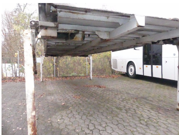
Bild 17: Rahmen und Stützbeine Korrosion - ohne Reparatur
