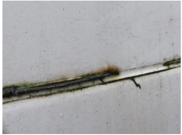
Bild 24: Seitenwand links Rostansatz, Korrosionsschaden nicht sach,- fachgerecht instandgesetzt, Korrosion - teillackieren
