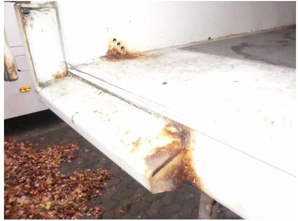
Bild 8: Portalrahmen unten Korrosion - lackieren
