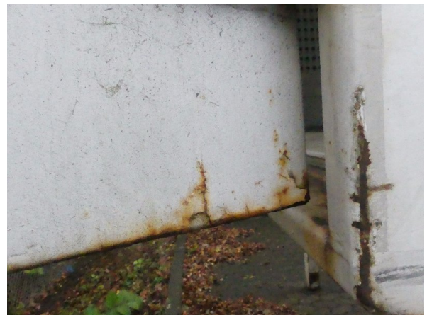
Bild 16: Tür rechts Korrosion - teillackieren
