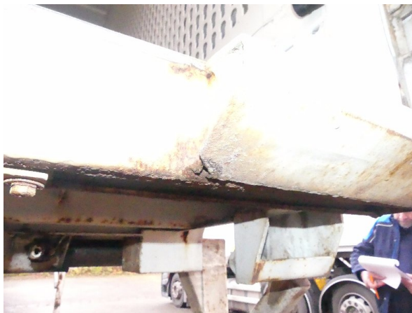
Bild 9: Portalrahmen unten Korrosion - lackieren
