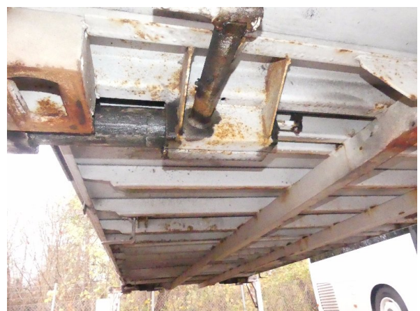
Bild 18: Rahmen und Stützbeine Korrosion - ohne Reparatur
