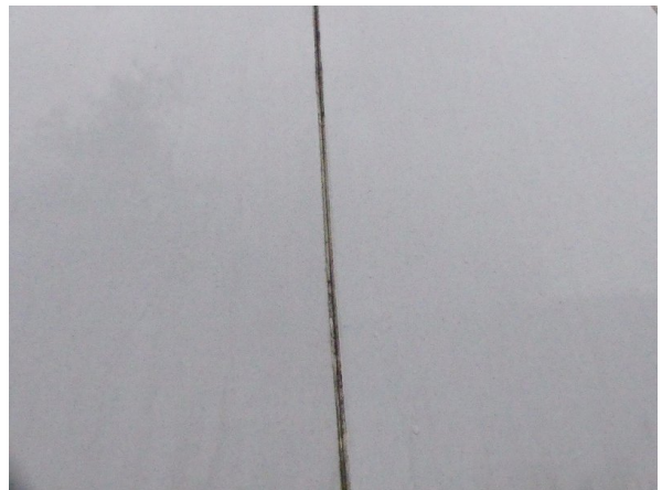
Bild 22: Seitenwand rechts Nahtabdichtung fehlt - instandsetzen
