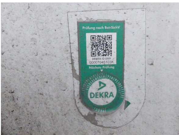
Bild 5: UVV Bescheinigung fehlt - erneuern
