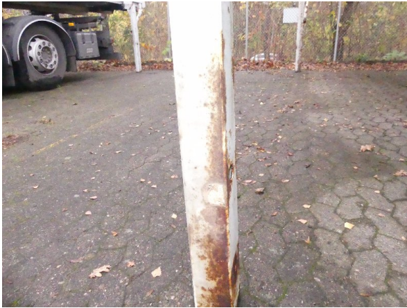
Bild 19: Rahmen und Stützbeine Korrosion - ohne Reparatur
