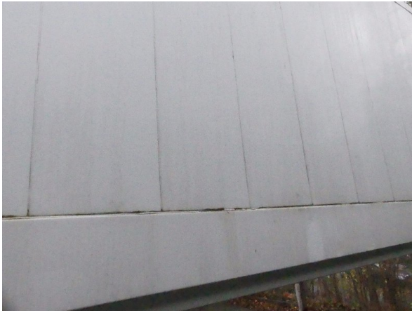
Bild 23: Seitenwand links Rostansatz, Korrosionsschaden nicht sach,- fachgerecht instandgesetzt, Korrosion - teillackieren
