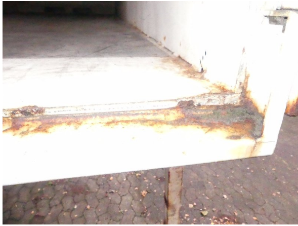
Bild 7: Portalrahmen unten Korrosion - lackieren
