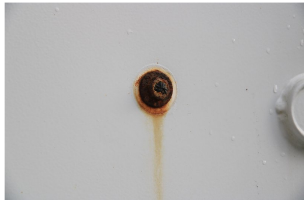
Bild 6: Anschlagpuffer Tür re. fehlt / weggerostet - ersetzen
