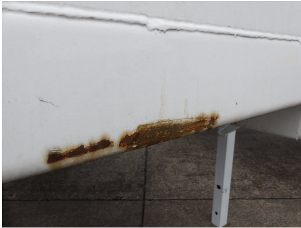
Bild 13: Frontwand Korrosion - instandsetzen und lackieren
