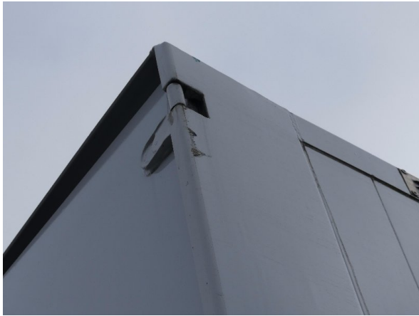
Bild 23: Eckbeplankung rechts Abschürfung - instandsetzen und lackieren
