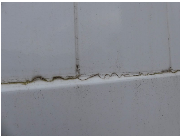
Bild 17: Abdichtung Frontwand, Seitenwand links und rechts beschädigt - erneuern
