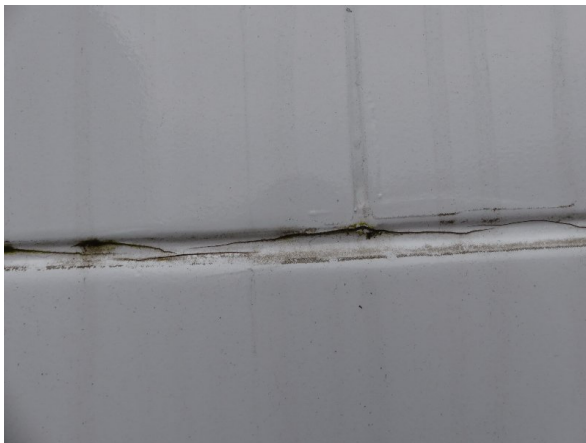
Bild 21: Abdichtung Frontwand, Seitenwand links und rechts beschädigt - erneuern
