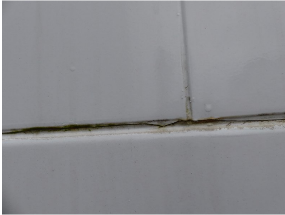
Bild 19: Abdichtung Frontwand, Seitenwand links und rechts beschädigt - erneuern
