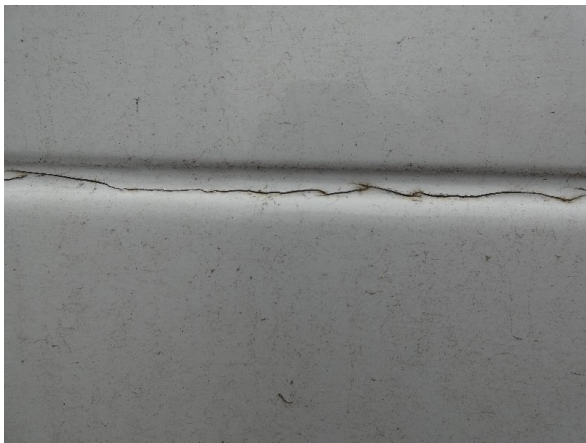
Bild 25: Seitenwand rechts und links Silikonnähte gerissen - erneuern
