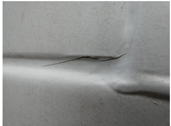
Bild 22: Seitenwand rechts und links Silikonnähte gerissen - erneuern
