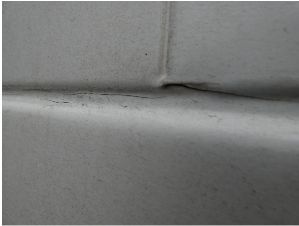
Bild 23: Seitenwand rechts und links Silikonnähte gerissen - erneuern
