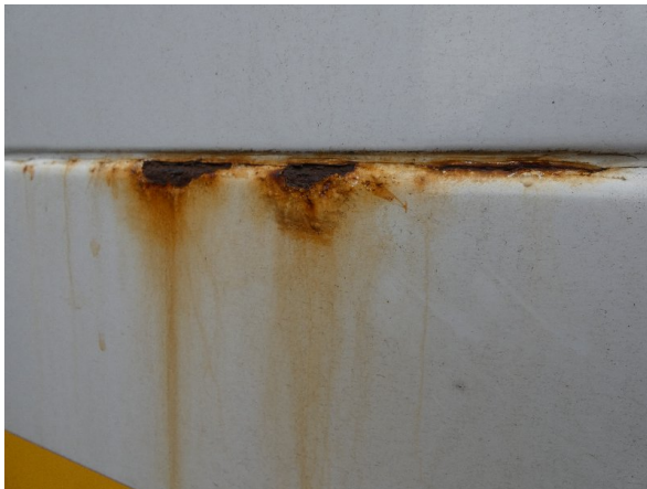
Bild 21: Seitenwand Kratzer/Korrosion - instandsetzen und lackieren
