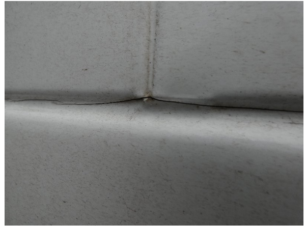
Bild 24: Seitenwand rechts und links Silikonnähte gerissen - erneuern
