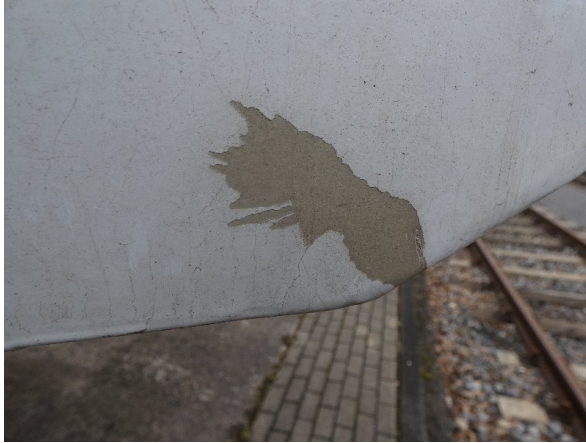
Bild 19: Seitenwand Kratzer/Korrosion - instandsetzen und lackieren
