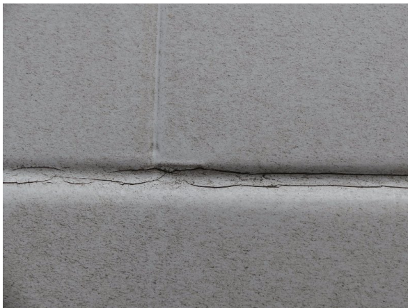
Bild 15: Abdichtung links und rechts beschädigt - erneuern
