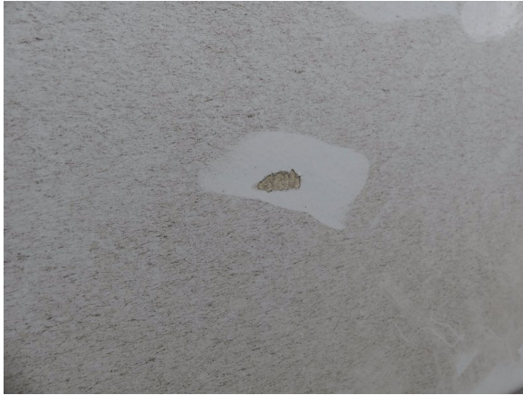
Bild 19: Seitenwand Lackmangel - Smart Repair
