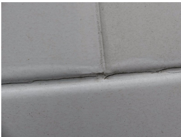
Bild 17: Abdichtung links und rechts beschädigt - erneuern
