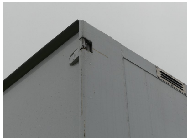
Bild 22: Eckbeplankung rechts Korrosion - instandsetzen und lackieren
