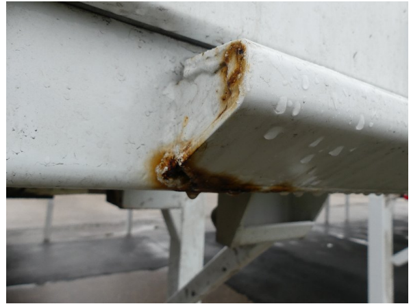
Bild 24: Eckbeplankung rechts Korrosion - instandsetzen und lackieren
