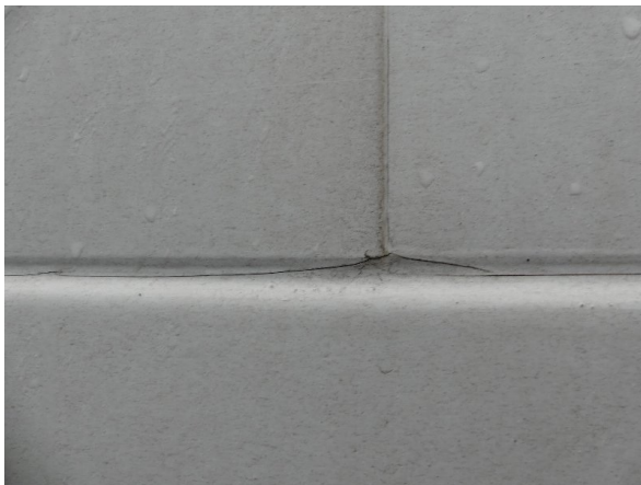
Bild 15: Abdichtung links und rechts beschädigt - erneuern
