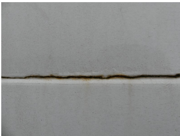
Bild 17: Abdichtung links und rechts beschädigt - erneuern
