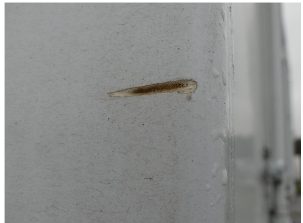
Bild 26: Eckbeplankung links Korrosion - instandsetzen und lackieren
