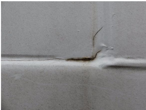
Bild 15: Abdichtung Seitenwand links und rechts beschädigt - erneuern
