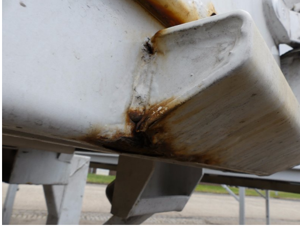
Bild 19: Eckbeplankung rechts Korrosion - instandsetzen und lackieren
