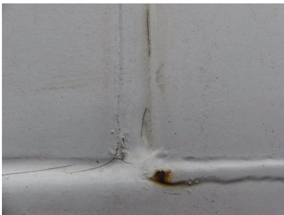
Bild 17: Abdichtung Seitenwand links und rechts beschädigt - erneuern
