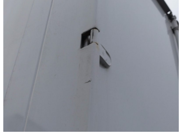
Bild 20: Eckbeplankung rechts Korrosion - instandsetzen und lackieren
