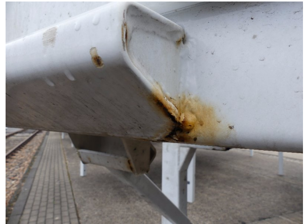
Bild 22: Eckbeplankung links Korrosion - instandsetzen und lackieren
