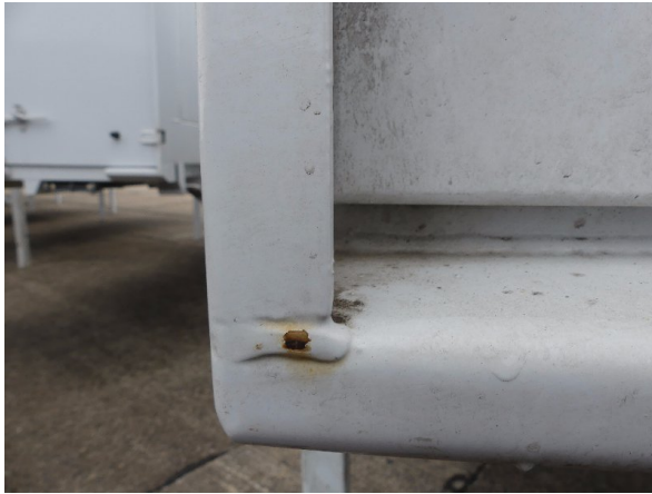
Bild 23: Eckbeplankung links Korrosion - instandsetzen und lackieren
