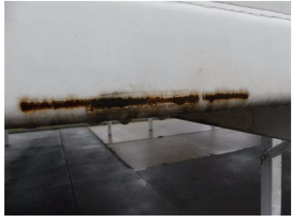
Bild 14: Frontwand Korrosion - instandsetzen und lackieren
