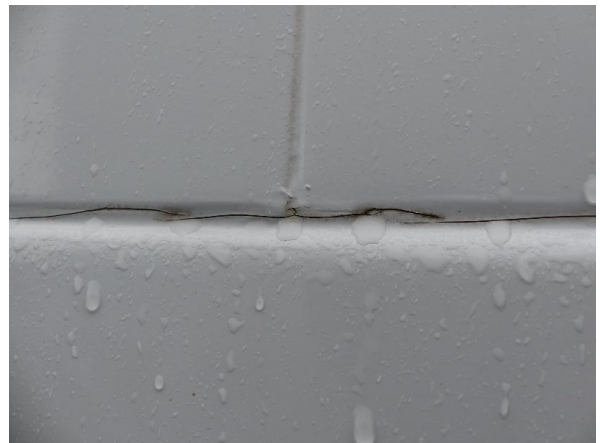
Bild 16: Abdichtung links und rechts beschädigt - erneuern
