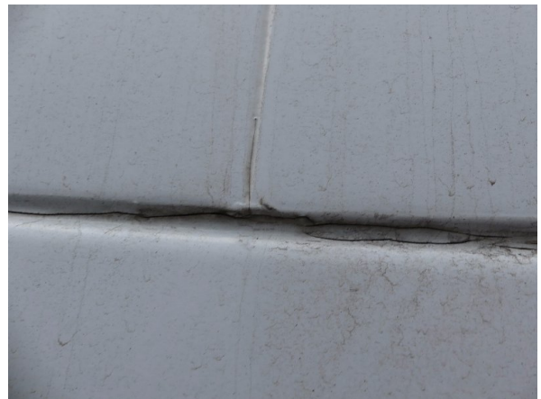
Bild 16: Abdichtung links und rechts beschädigt - erneuern
