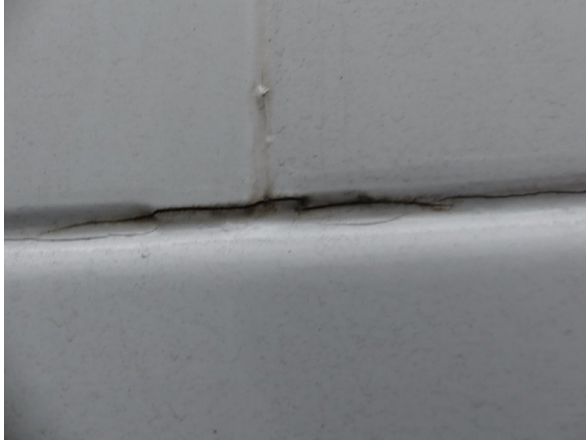
Bild 19: Abdichtung links und rechts beschädigt - erneuern
