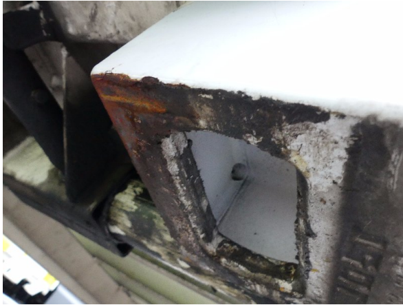
Bild 39: Karosserie / Innenraum Delle / Kratzer / Steinschlag / Abschürfung-ohne Reparatur
