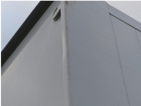
Bild 21: Eckbeplankung rechts Abschürfungen / Korrosion - instandsetzen und lackieren
