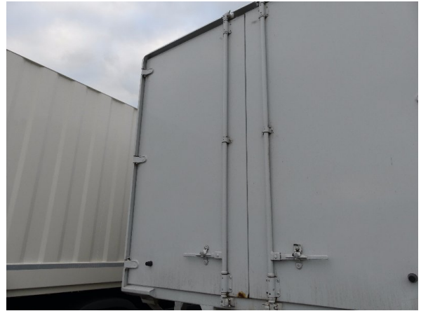
Bild 24: Hecktür links Korrosion - instandsetzen und lackieren
