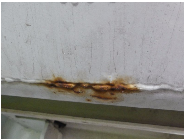
Bild 27: Eckbeplankung unterhalb links Korrosion - instandsetzen und lackieren
