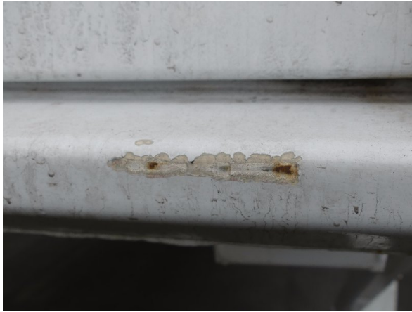
Bild 23: Eckbeplankung rechts Abschürfungen / Korrosion - instandsetzen und lackieren
