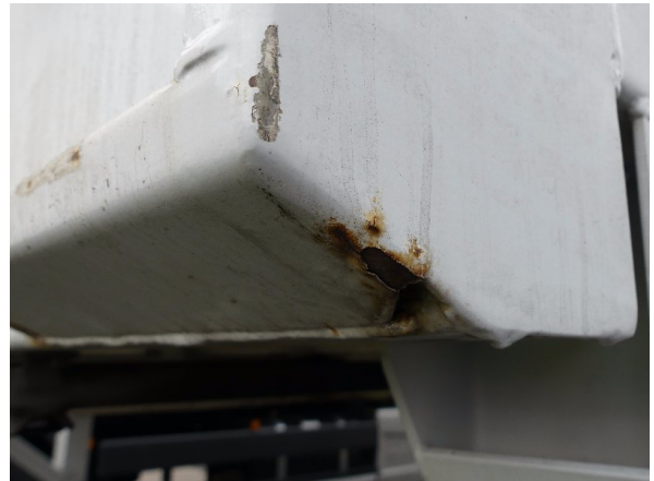
Bild 22: Eckbeplankung rechts Abschürfungen / Korrosion - instandsetzen und lackieren
