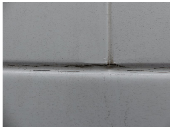
Bild 18: Abdichtung links und rechts beschädigt - erneuern
