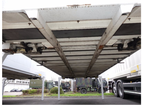
Bild 44: Karosserie / Innenraum Delle / Kratzer / Steinschlag / Abschürfung-ohne Reparatur
