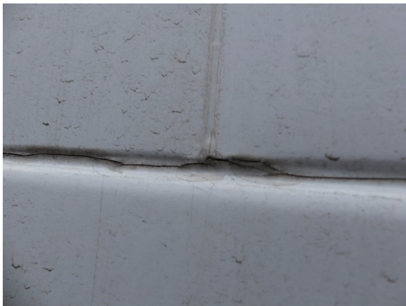
Bild 15: Abdichtung links und rechts beschädigt - erneuern
