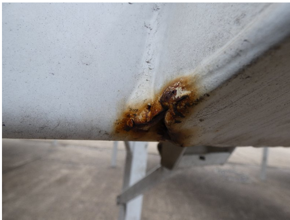
Bild 15: Heckbereich Kratzer/Korrosion - instandsetzen und lackieren
