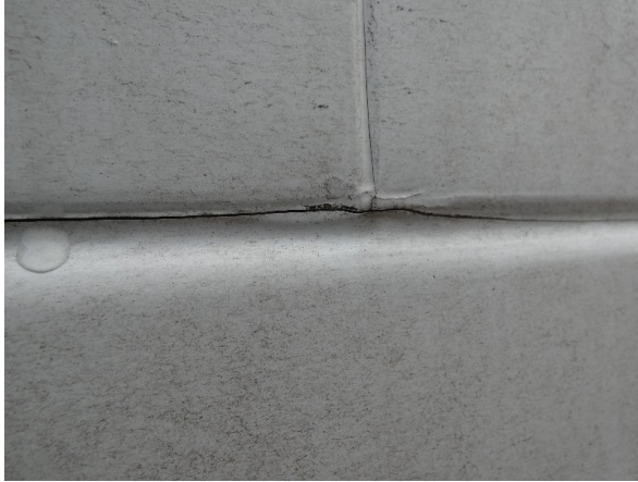
Bild 19: Seitenwand rechts und links Silikonnähte gerissen - erneuern
