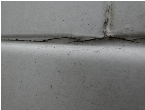
Bild 21: Seitenwand rechts und links Silikonnähte gerissen - erneuern
