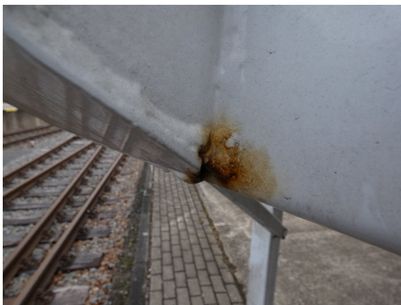
Bild 17: Heckbereich Kratzer/Korrosion - instandsetzen und lackieren
