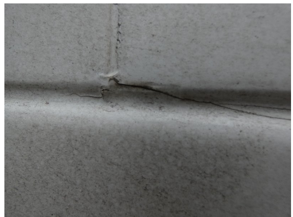
Bild 18: Seitenwand rechts und links Silikonnähte gerissen - erneuern
