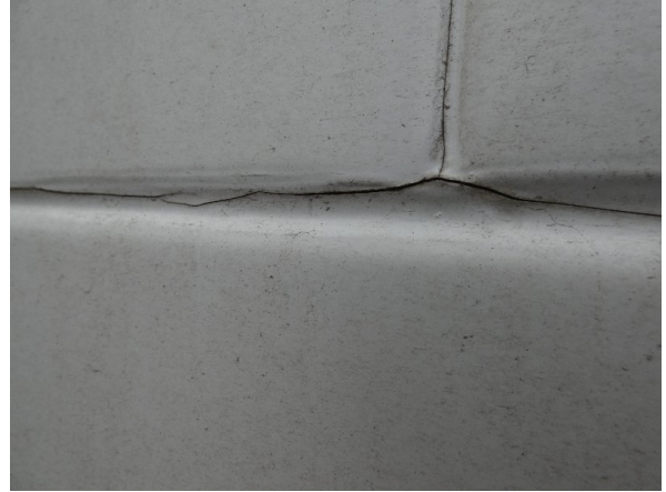
Bild 20: Seitenwand rechts und links Silikonnähte gerissen - erneuern
