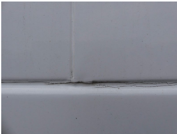
Bild 15: Abdichtung Seitenwand links und rechts beschädigt - erneuern
