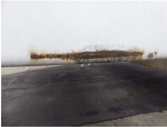
Bild 13: Frontwand Korrosion - instandsetzen und lackieren
