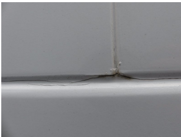
Bild 17: Abdichtung Seitenwand links und rechts beschädigt - erneuern
