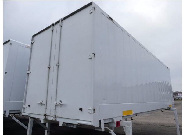
Bild 20: Eckbeplankung rechts Abschürfung - instandsetzen und lackieren
