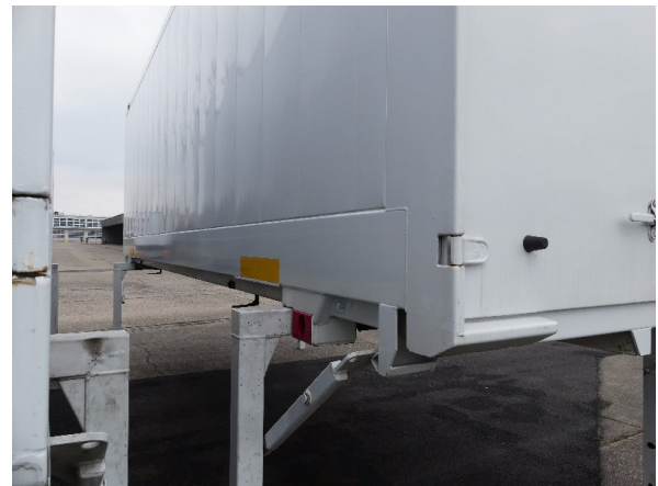
Bild 16: Abdichtung Seitenwand links und rechts beschädigt - erneuern
