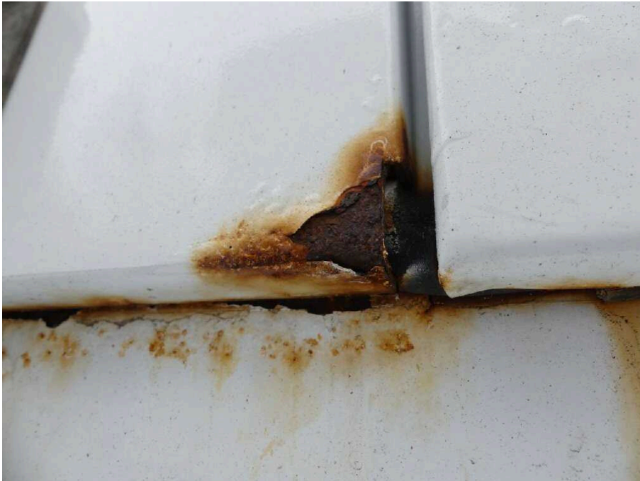
Bild 23 Fahrzeugheck Heckflügeltür links stark korrodiert
