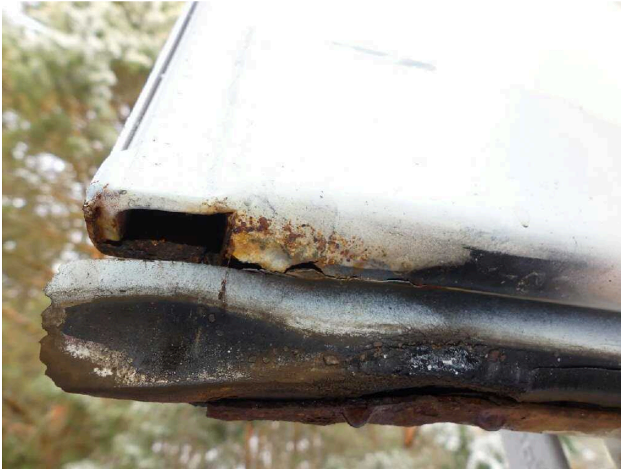
Bild 29 Fahrzeugheck Heckflügeltür links stark korrodiert und keine fachgerechte Reparatur
