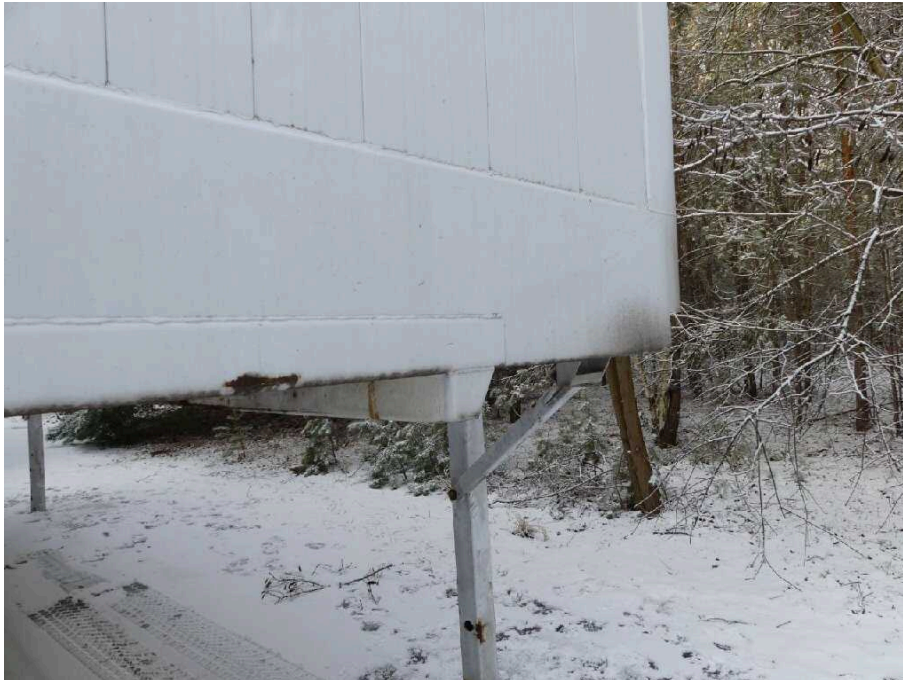
Bild 9 Aufbau Bodenrahmen vorne korrodiert
