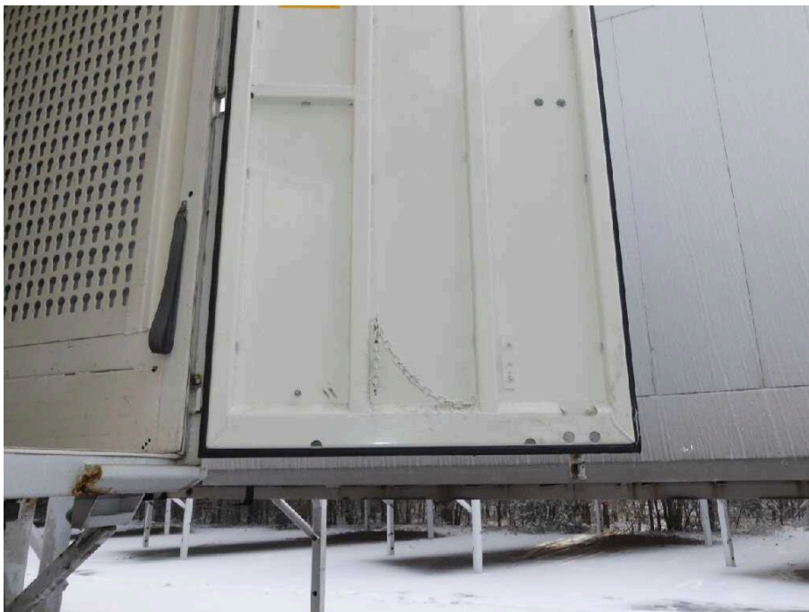
Bild 40 Fahrzeugheck Heckflügeltür rechts korrodiert
