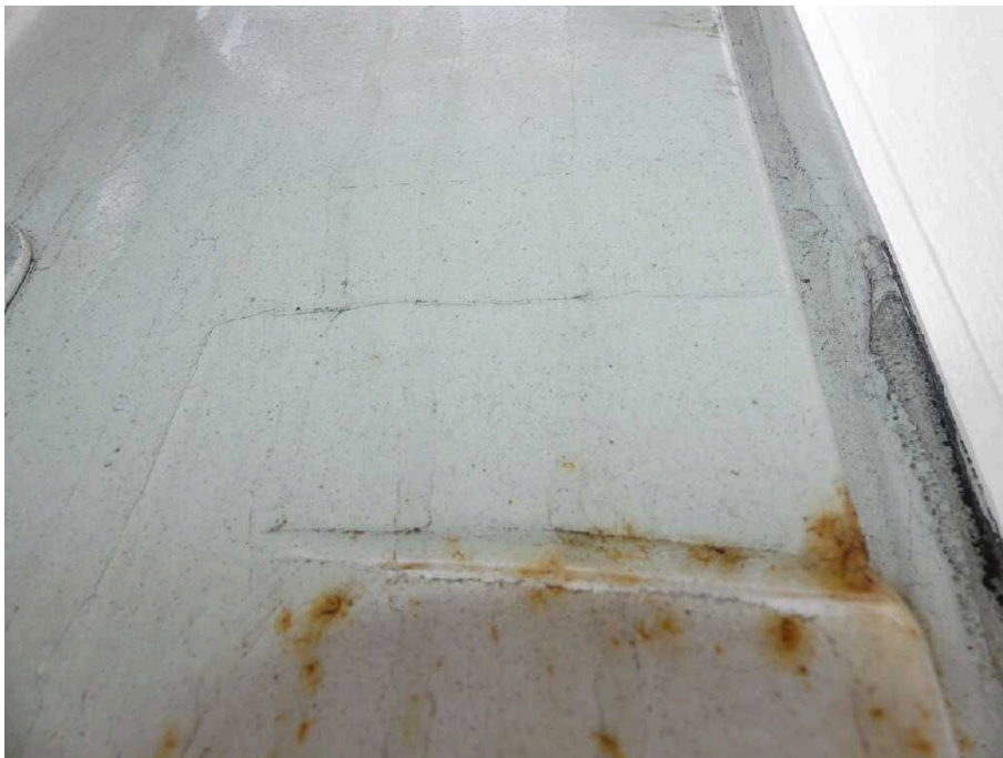
Bild 26 Fahrzeugheck Heckflügeltür links stark korrodiert und keine fachgerechte Reparatur
