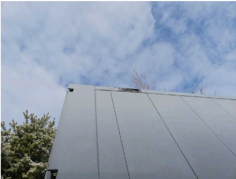
Bild 34 rechte Seite Seitenwand rechts Lüftungsgitter hi.re. oben deformiert
