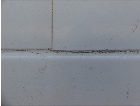
Bild 29: Abdichtung links und rechts beschädigt - erneuern
