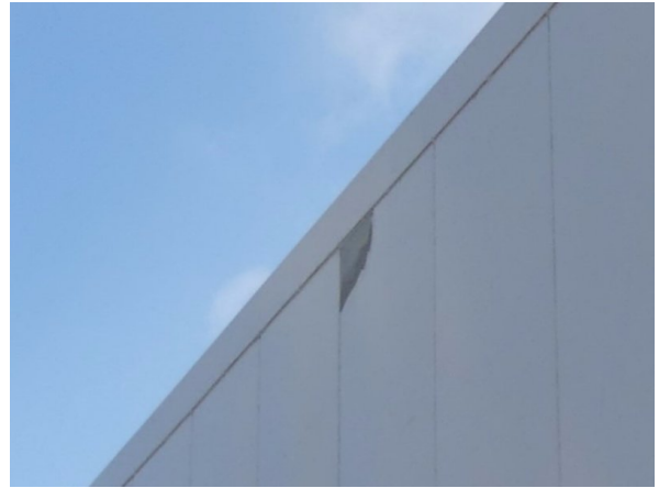
Bild 24: Seitenwand Lackmangel - lackieren
