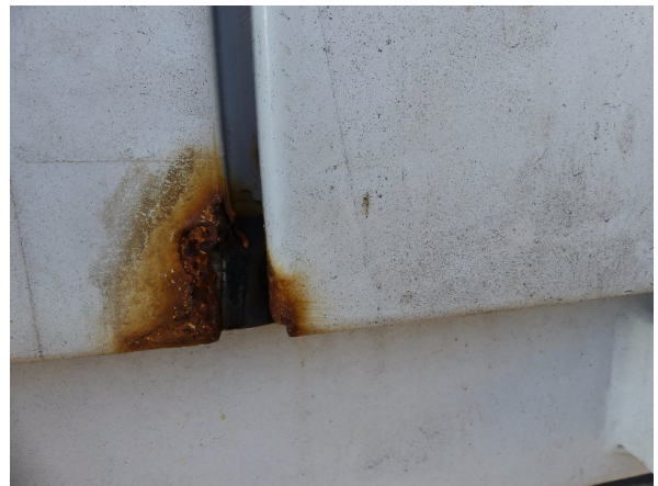
Bild 16: Tür Korrosion - instandsetzen und lackieren
