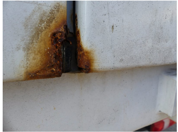
Bild 14: Tür Korrosion - instandsetzen und lackieren
