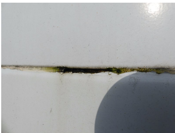
Bild 27: Abdichtung links und rechts beschädigt - erneuern
