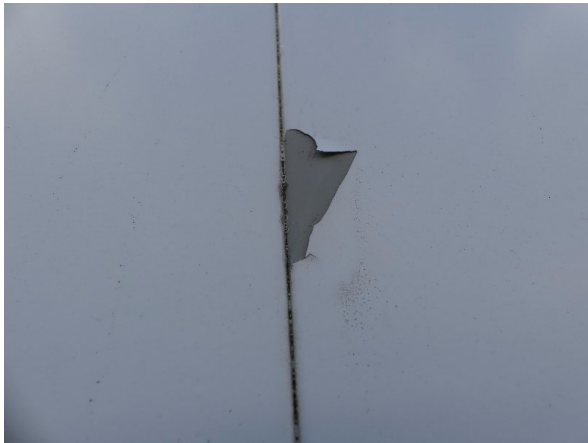
Bild 25: Seitenwand Lackmangel - lackieren
