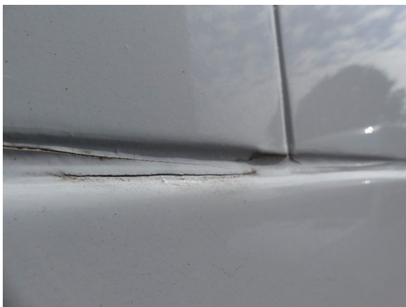
Bild 17: Abdichtung links und rechts beschädigt - erneuern
