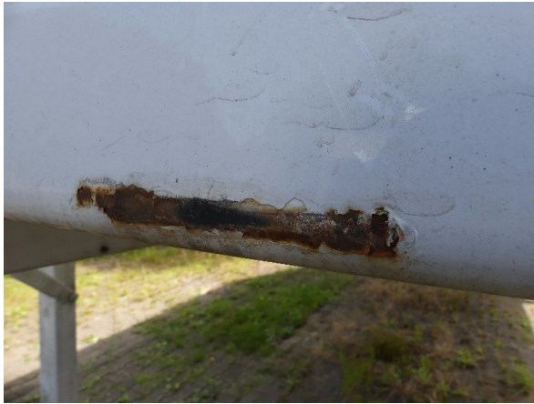
Bild 13: Frontwand Korrosion - instandsetzen und lackieren
