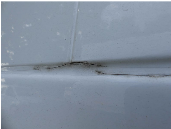
Bild 15: Abdichtung links und rechts beschädigt - erneuern
