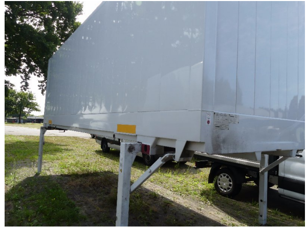
Bild 14: Abdichtung links und rechts beschädigt - erneuern
