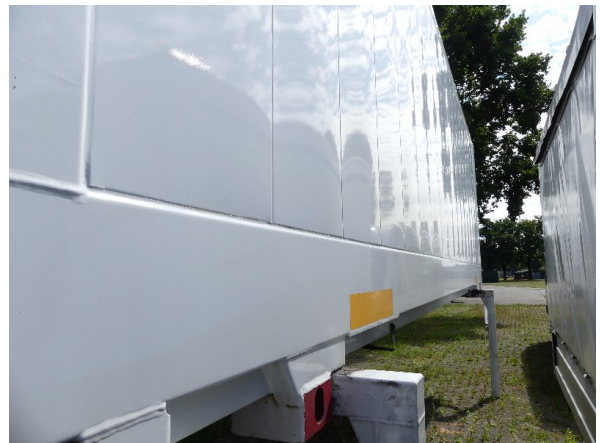
Bild 16: Abdichtung links und rechts beschädigt - erneuern
