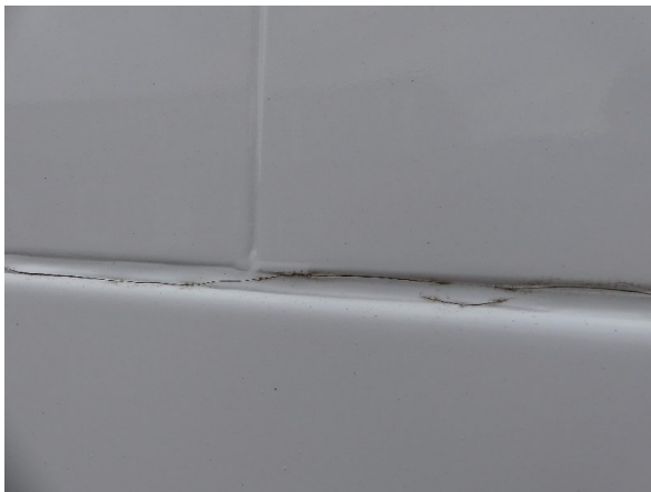
Bild 21: Abdichtung links und rechts beschädigt - erneuern
