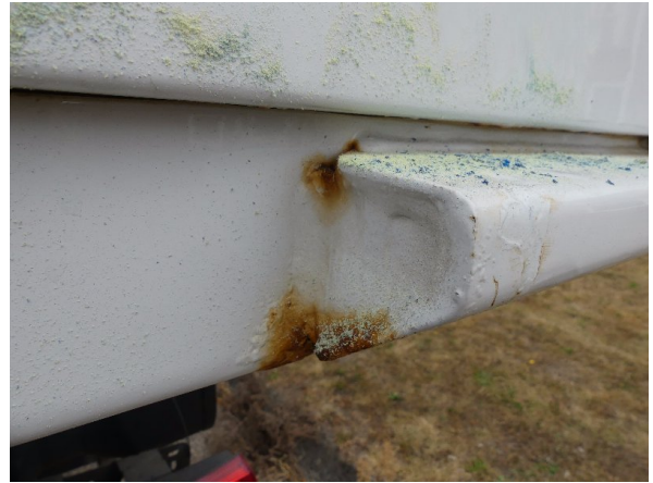
Bild 14: Eckbeplankung rechts Korrosion - instandsetzen und lackieren
