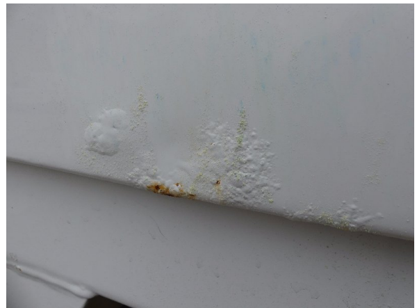
Bild 16: Tür Korrosion - instandsetzen und lackieren
