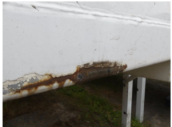
Bild 26: Frontwand Korrosion - instandsetzen und lackieren
