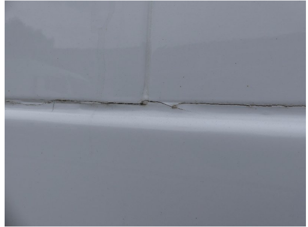
Bild 20: Abdichtung links und rechts beschädigt - erneuern
