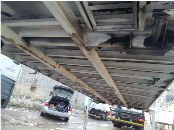
Beschädigung 1: Aufbau: Aufbau - Korrosion - instandsetzen und lackieren
