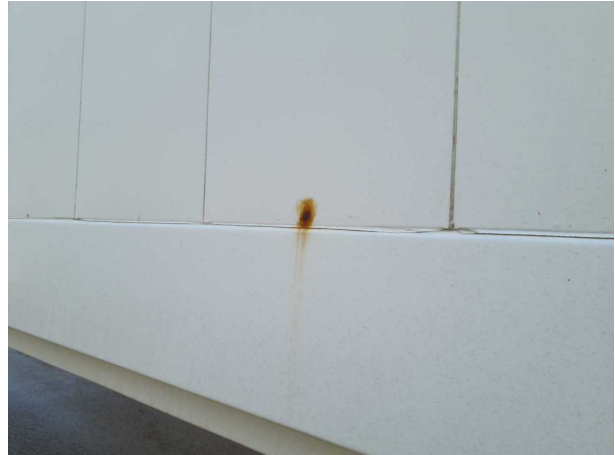
Beschädigung 1: Aufbau: Aufbau - Korrosion - instandsetzen und lackieren
