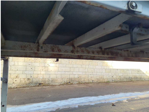
Beschädigung 1: Aufbau: Aufbau - Korrosion - instandsetzen und lackieren
