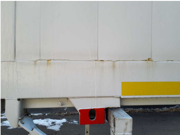
Beschädigung 1: Aufbau: Aufbau - Korrosion - instandsetzen und lackieren
