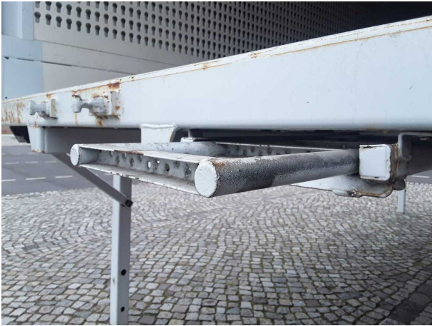
Beschädigung 1: Ausrüstung: Leiter (Sicherung fehlt) - erneuern
