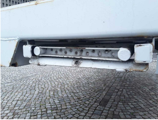
Beschädigung 1: Ausrüstung: Leiter (Sicherung fehlt) - erneuern
