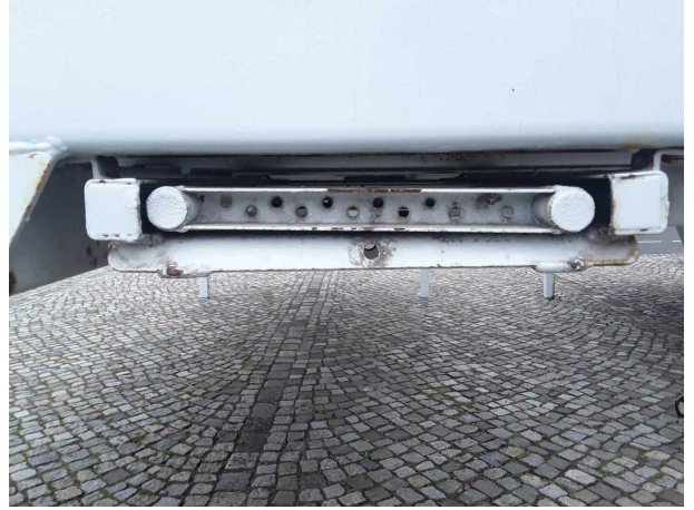
Beschädigung 1: Ausrüstung: Leiter (Sicherung fehlt) - erneuern
