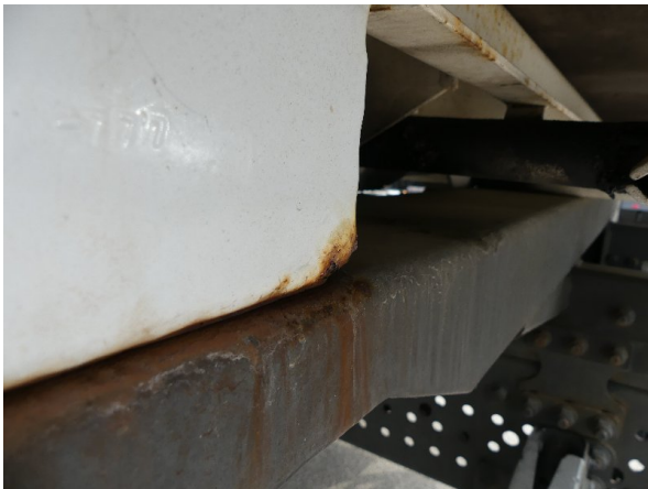
Bild 19: Aufnahmen hinten rechts, hinten links und vorne links Korrosion - instandsetzen und lackieren
