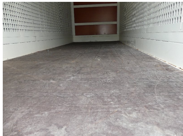
Bild 30: Gewicht fehlt - erneuern
