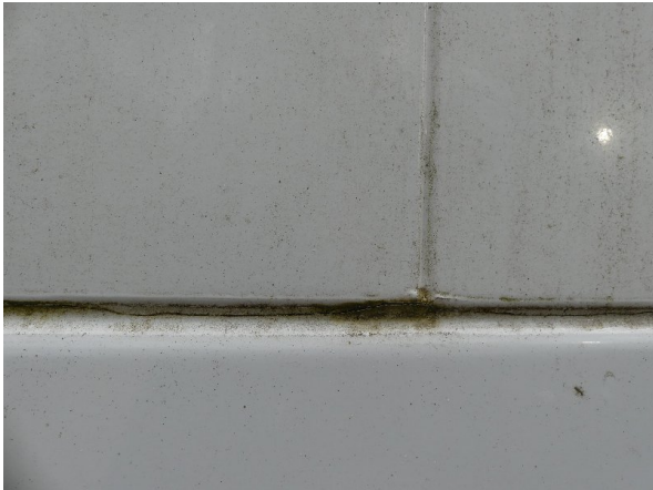
Bild 15: Abdichtung Seitenwände beschädigt - erneuern
