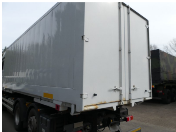
Bild 24: Eckbeplankung links Korrosion - instandsetzen und lackieren
