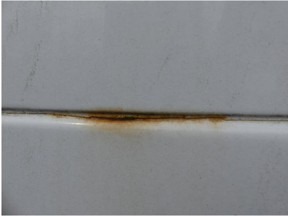
Bild 13: Abdichtung Seitenwände beschädigt - erneuern
