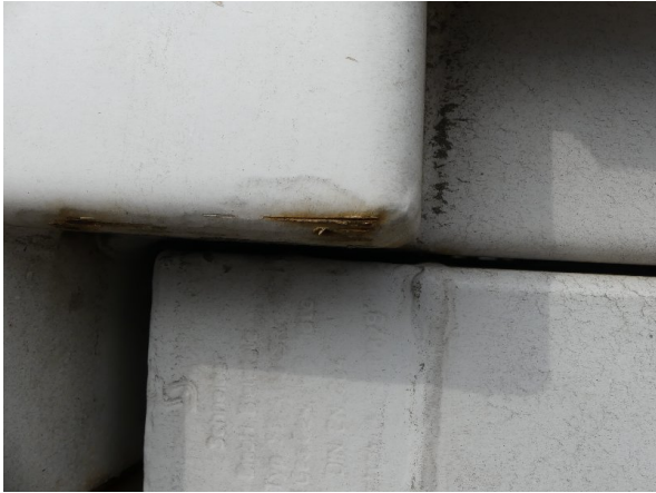
Bild 17: Aufnahmen hinten rechts, hinten links und vorne links Korrosion - instandsetzen und lackieren
