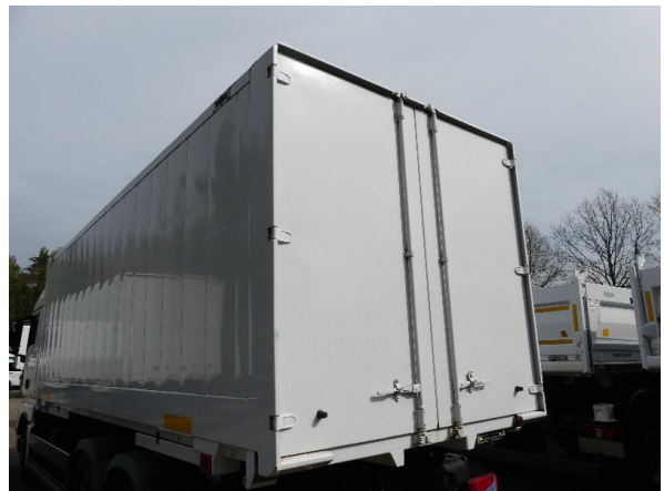
Bild 18: Eckbeplankung links Korrosion - instandsetzen und lackieren
