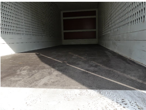
Bild 27: Gewicht fehlt - erneuern
