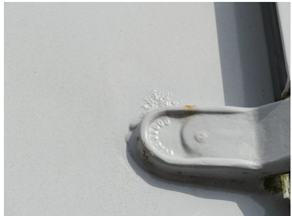
Bild 22: Tür rechts Korrosion - instandsetzen und lackieren
