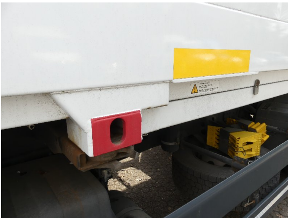
Bild 25: Aufnahme vorne links Korrosion - instandsetzen und lackieren
