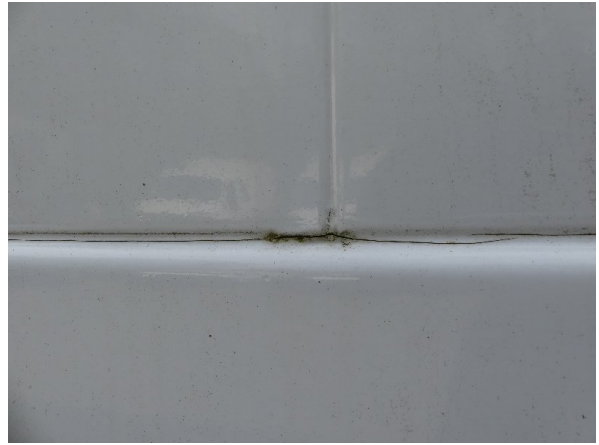
Bild 14: Abdichtung Seitenwände beschädigt - erneuern
