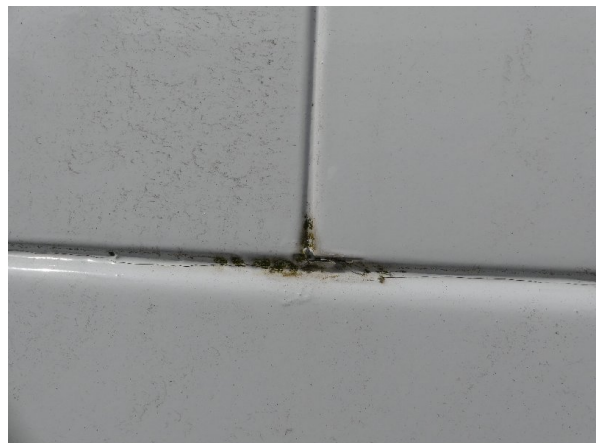
Bild 12: Abdichtung Seitenwände beschädigt - erneuern
