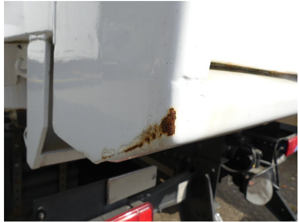
Bild 20: Eckbeplankung links Korrosion - instandsetzen und lackieren
