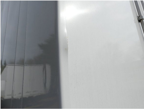
Bild 19: Eckbeplankung links Korrosion - instandsetzen und lackieren
