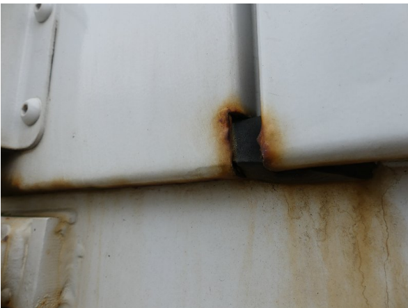
Bild 15: Hecktür links Korrosion - instandsetzen und lackieren
