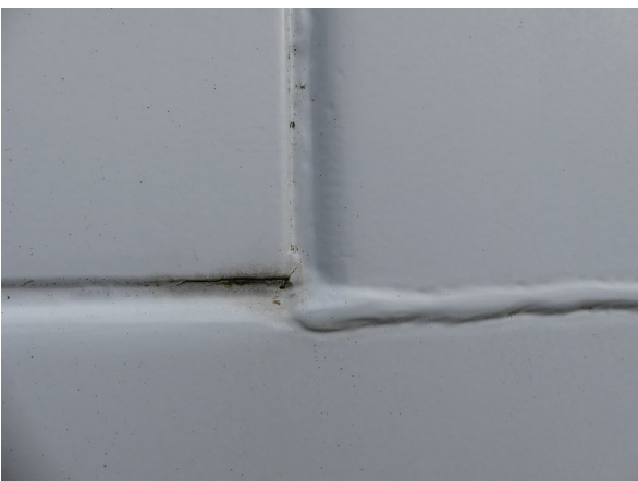
Bild 17: Abdichtung Seitenwände beschädigt - erneuern
