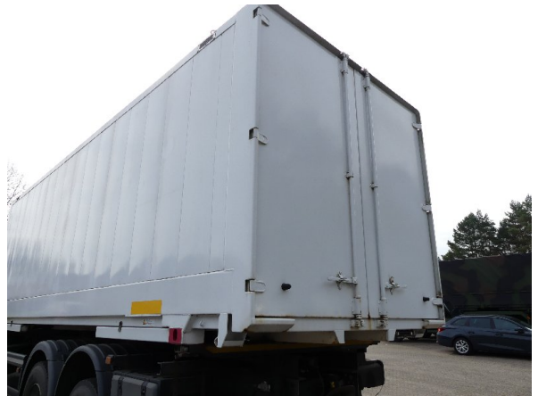
Bild 22: Eckbeplankung links Korrosion - instandsetzen und lackieren
