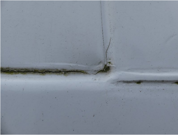
Bild 19: Abdichtung Seitenwände beschädigt - erneuern
