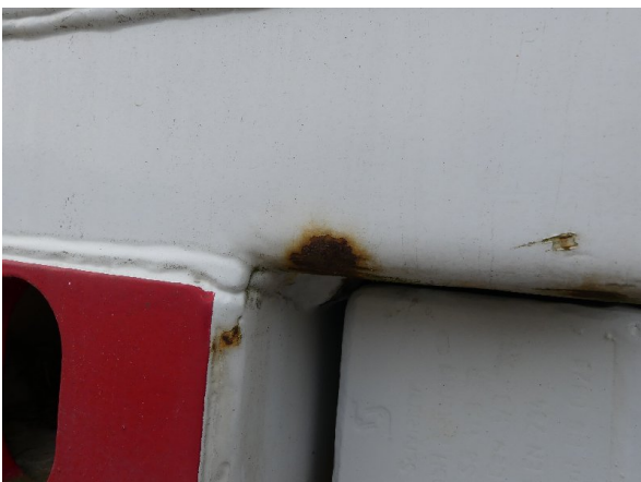
Bild 27: Aufnahmen links Korrosion - instandsetzen und lackieren
