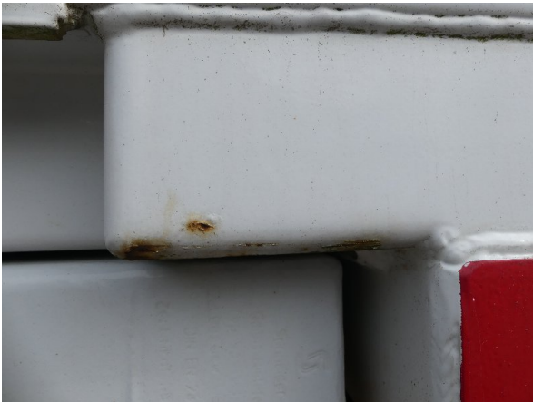
Bild 25: Aufnahmen links Korrosion - instandsetzen und lackieren
