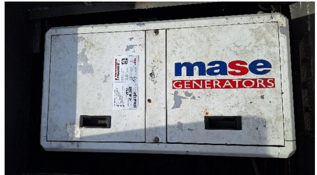
Hinweis: Der Generator ist defekt.
